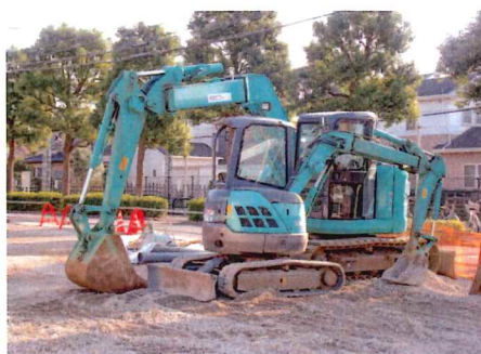
工事現場の電源として
